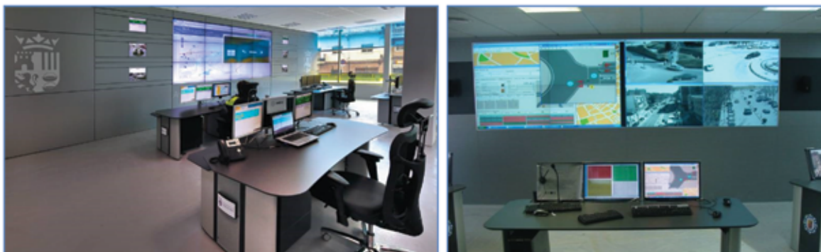
Figura 104. Centro de Control y Gestión del Tráfico
